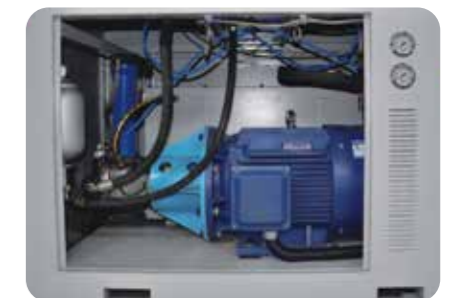
Siemens Main Motor
